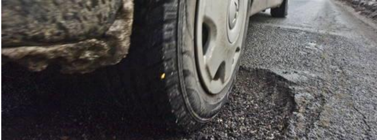
Nach dem Tauwetter werden die Schlaglöcher sichtbar. Foto: Peter Riecke
