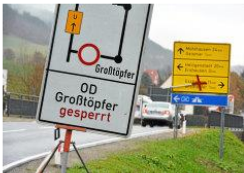
Dieser Tage wird im Bereich der Ortsdurchfahrt Großtöpfer die Betumdecke aufgebracht. Foto: Eckhard Jüngel
